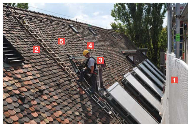
Bild 12 Arbeitsplatz-Positionierungssystem auf einem geneigten Dach
